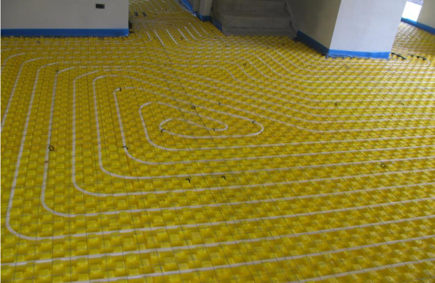
RISCALDAMENTO A PAVIMENTO
